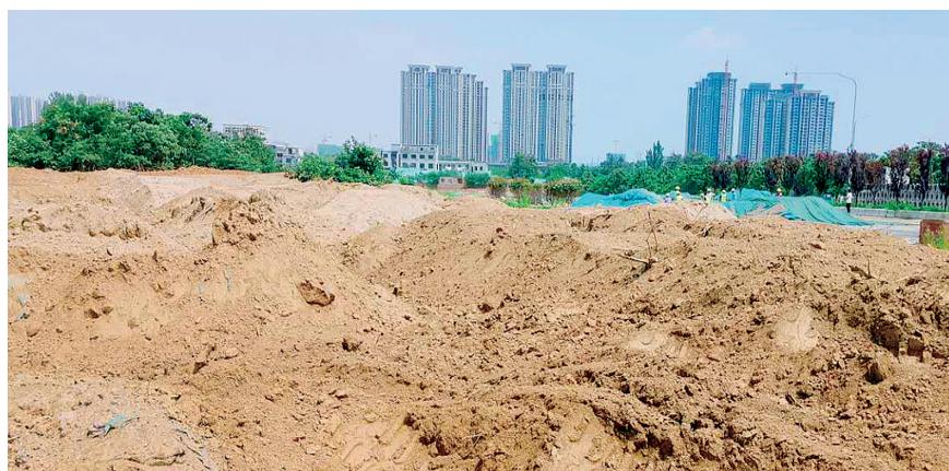
郑州黄海置业有限公司待建工地大面积黄土裸露
