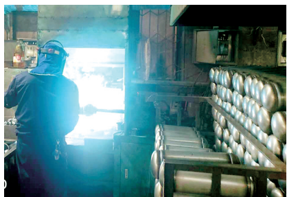
郑州中岳消防器材公司违规焊接
