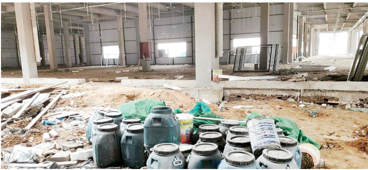
华丰钢铁物流园A5区废油漆桶随意堆放
