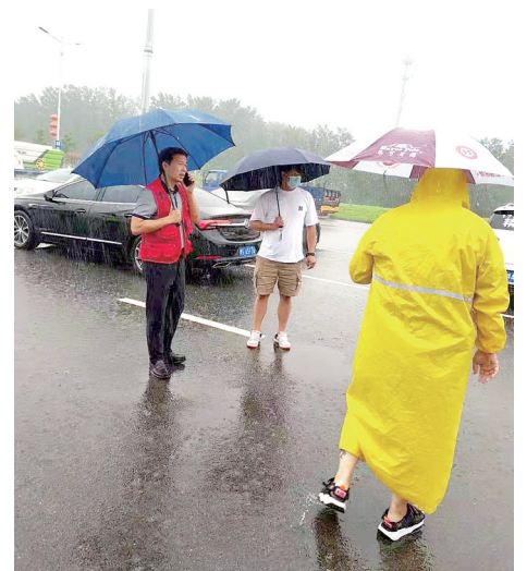
枫杨办事处党工委书记李广辉到长椿路涵洞察看指导防洪工作
