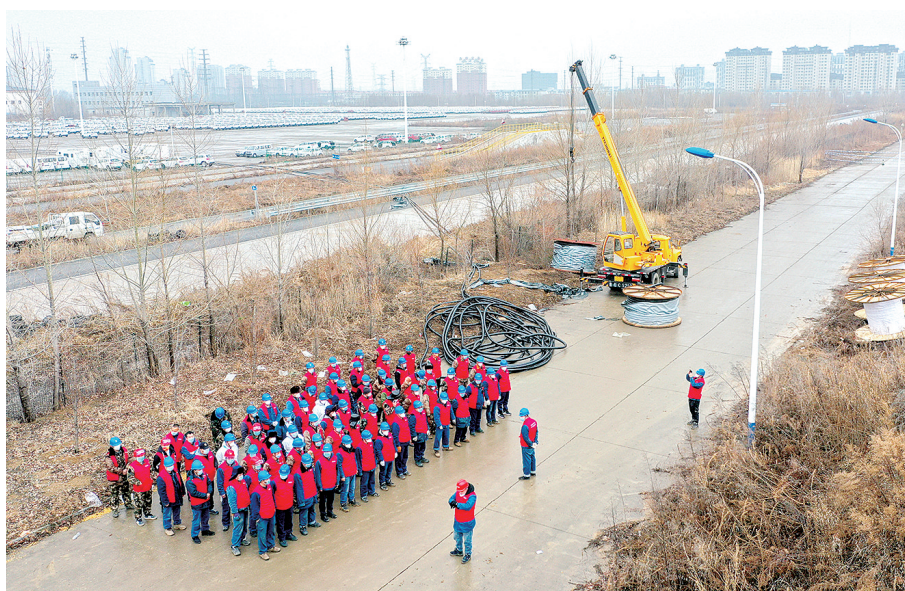
14日,设有6000间隔离间的吉林市高新南区隔离方舱开工建设 新华社发
