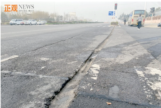
华夏大道上的沟槽
