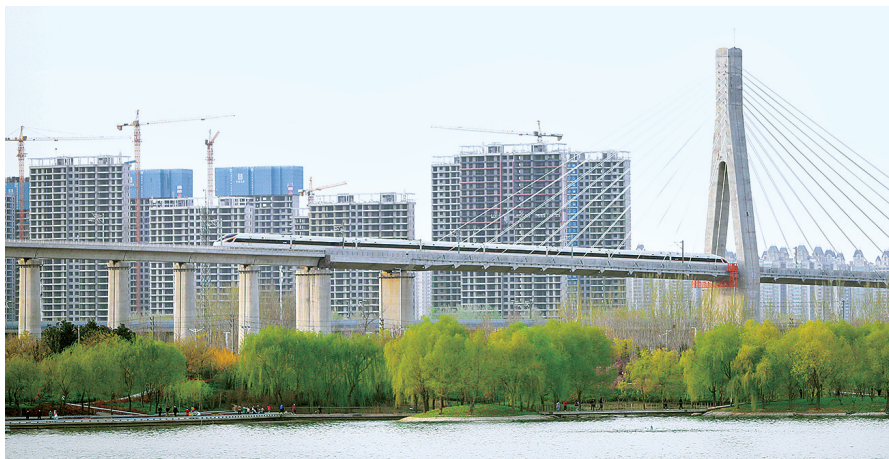
郑州蝶湖周围一批土地项目正在建设 正观新闻·郑州晚报记者 李新华 图
