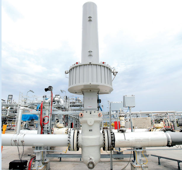
新投产的罗马尼亚康斯坦察县瓦杜村天然气处理站 新华社发
