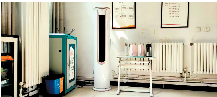
柜式空调已安装到位
