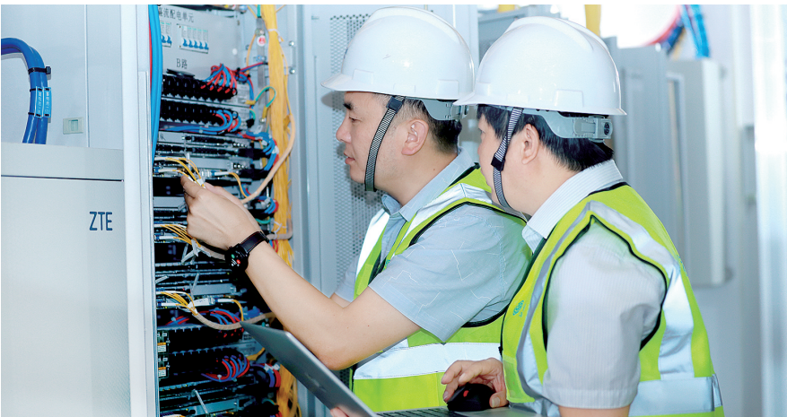
刘凤祥(左)和同事对基站机房进行检查
