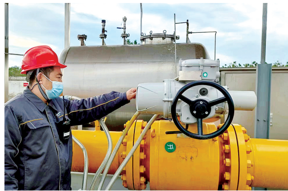
郑州华润燃气荥阳门站运行工杨光在巡视设备
