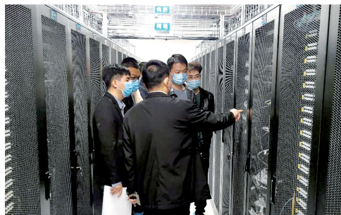
大数据管理局验收组进行机房实地勘验
