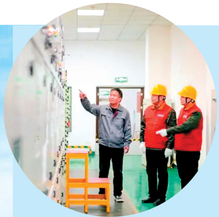
国网洛阳供电公司工作人员了解企业用电需求
