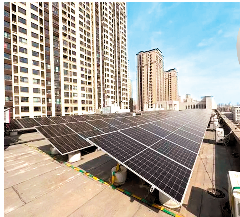
汉威科技集团股份有限公司园区内的屋顶光伏项目 新华社发
