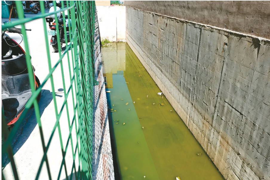
中原人家小区北院立体车库基坑积满污水
