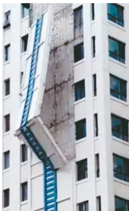
哈尔滨某高层建筑外墙脱落场景
