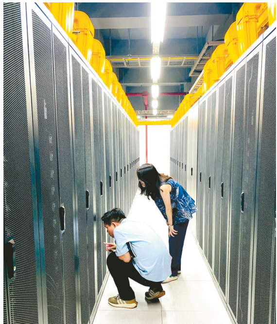
工作人员在APUS智算中心机房巡查
