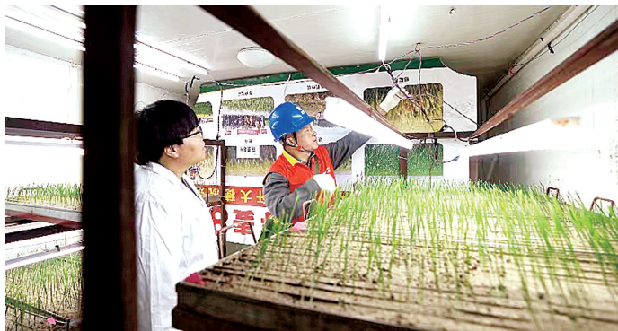
电力网格员在育种站检查供电线路
