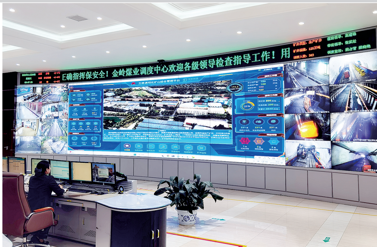
基于智能调度指挥平台,金岭煤矿实现了统一调度、统一管理、统一监控、智能联动
