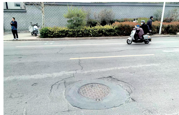
频繁碾压过的窨井盖
