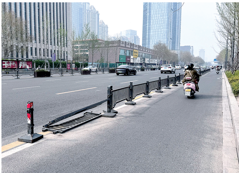
护栏断裂倒地
