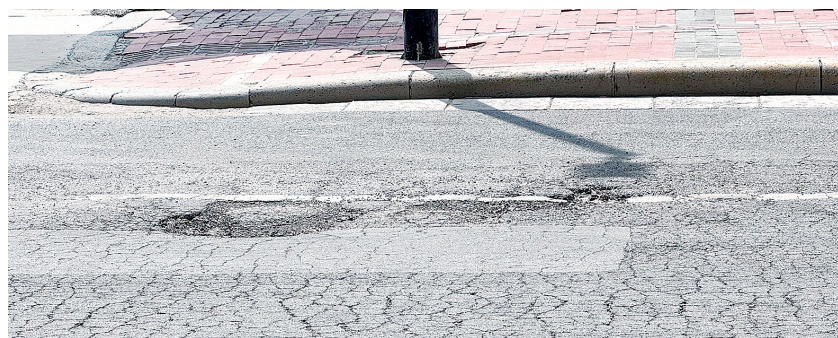
纬二路路面龟裂坑洼
