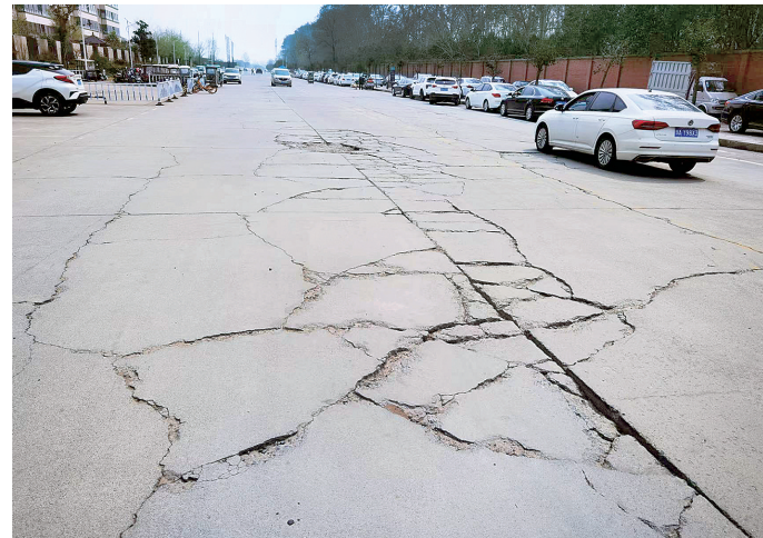
惠济区新兴街中间一段破损严重
