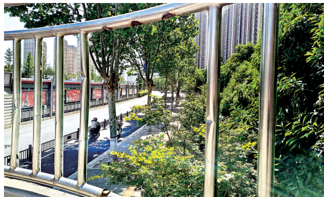
天桥坡道处护栏缺损
