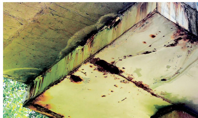
过街天桥生锈严重
