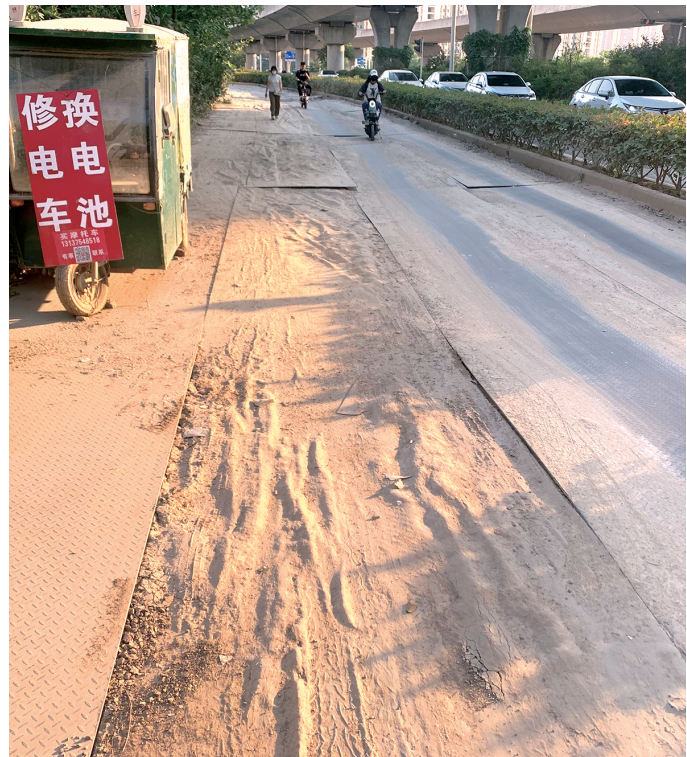
非机动车路面坑洼不平
