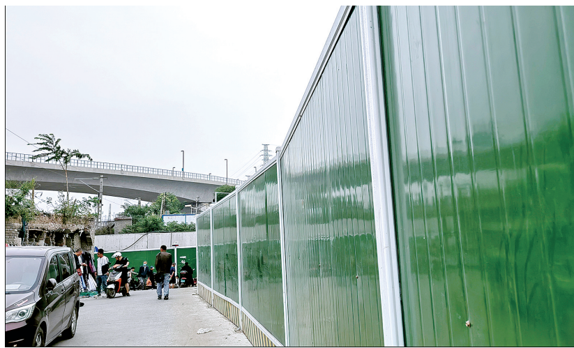
沿河路施工围挡影响正常通行
