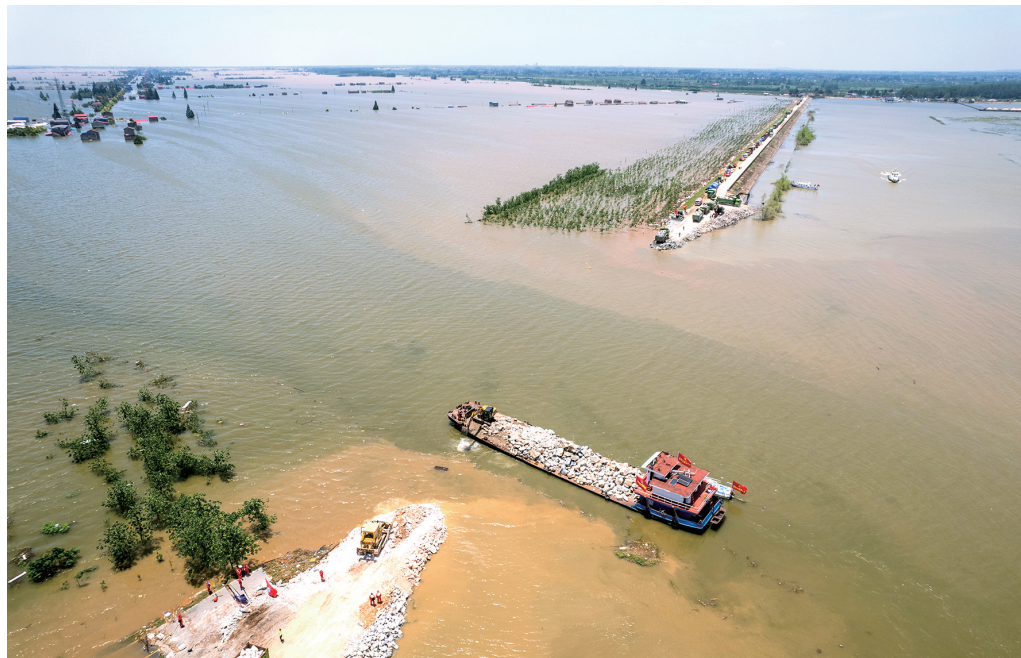
华容县团洲垸洞庭湖大堤决口现场，抢险队伍在进行堵口作业（无人机照片）新华社发
