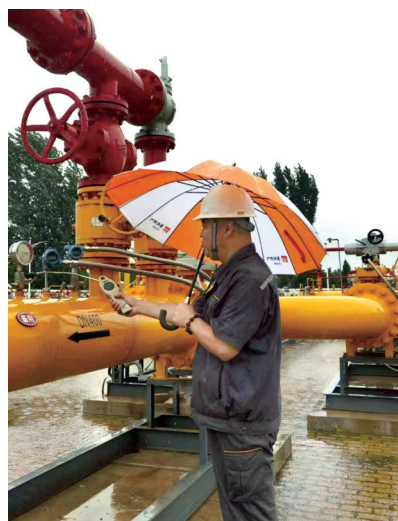
工作人员雨中检测燃气设备运行
