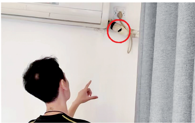
摄像头安装在空调和管道连接处 视频截图
