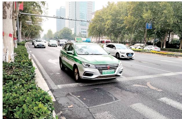
路坑已修复填平
