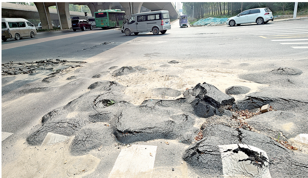
破损路面像波浪起伏
