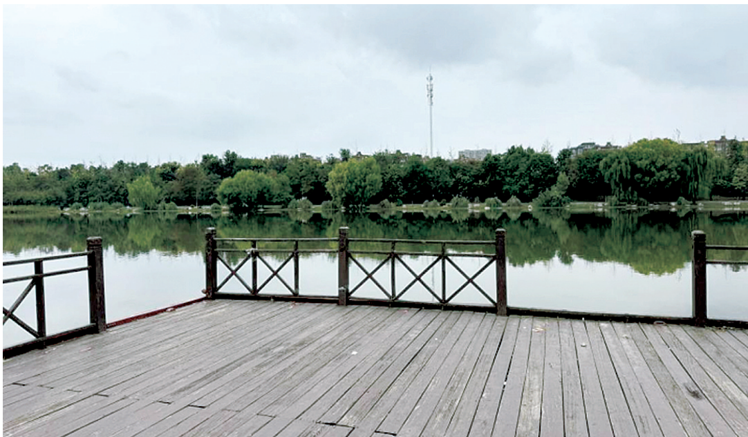
贾鲁河观景露台护栏缺损
